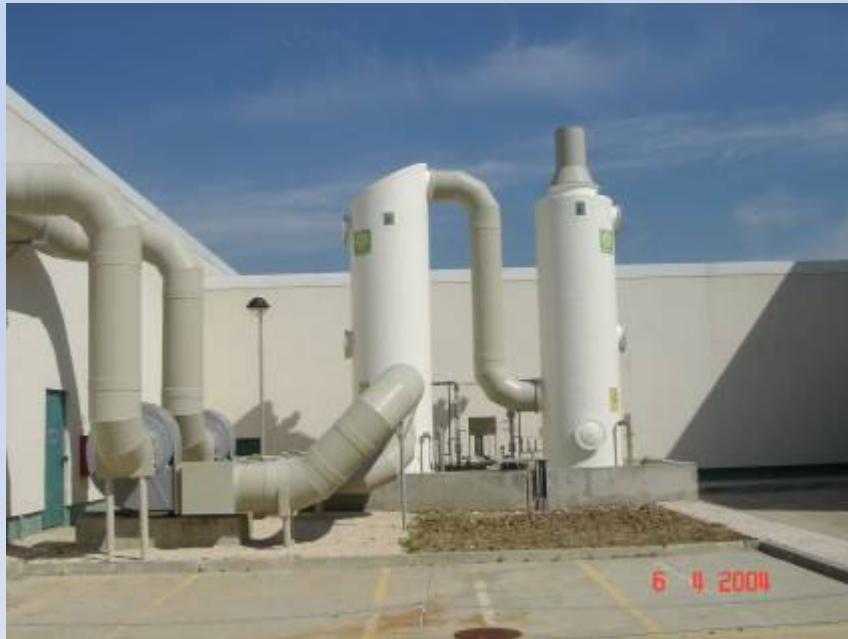
Controlo de Odores
