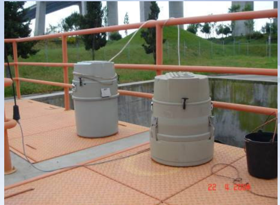
Monitorização do efluente final
