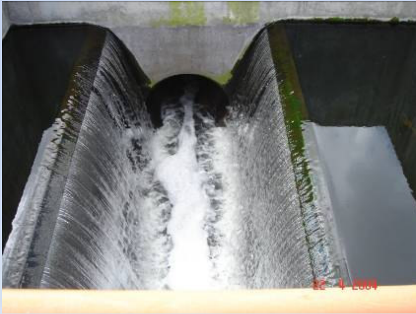
Descarga de AR tratada
