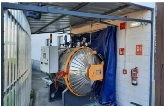
CSIC : Installation pilote du traitement HTC mise en place sur le site de Cogersa
